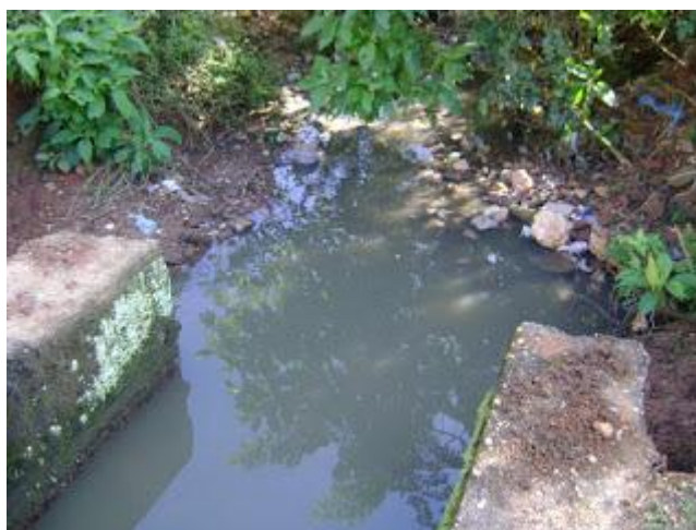
Esgoto a céu aberto corre livremente para o Rio das Mortes atrás do Conjunto INOCOP, sob a linha férrea da Maria Fumaça. 2009.
