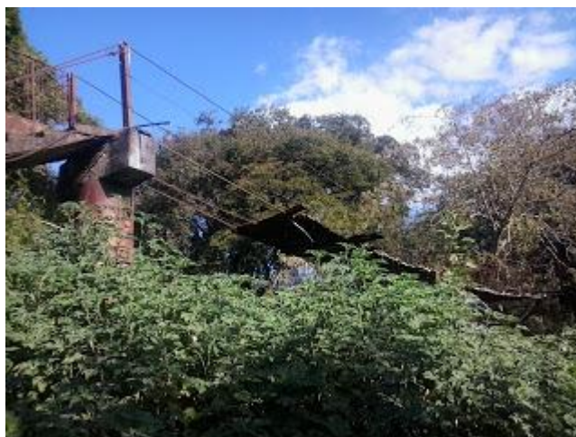
Ponte pênsil em Matosinhos, ora abandonada e em estado precário. 11/08/2013.
